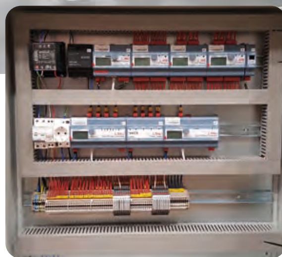
Cuadros de control totalmente acabados
